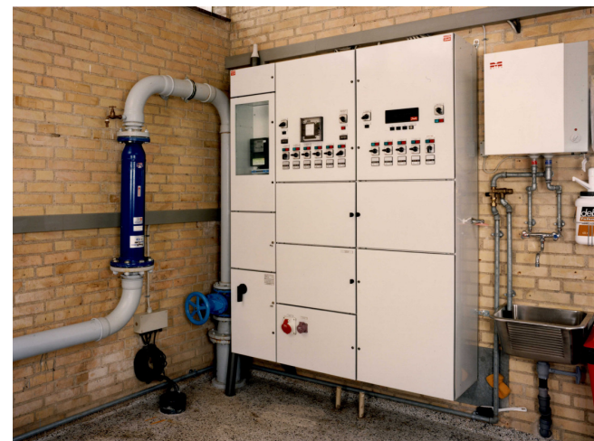
Eltavle efter renovering i 1991
